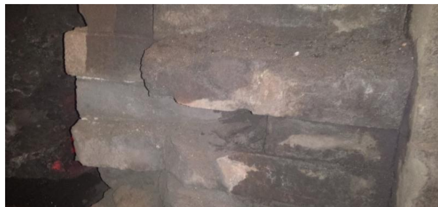
Das Foto zeigt den Zustand der Auskleidung rechts von der Abstichöffnung (Südosten).
